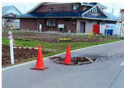
「稲瀬町の道路」 投稿名:「black rider」さん 稲瀬町の道路です。震災の影響でマンホールのまわりが陥没しており、どんとんひとく なっています。
