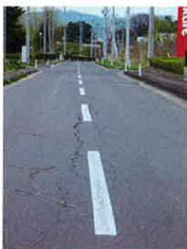
「道路に亀裂」 投稿名:「シャンミ」さん 南部工業団地の「オシタリ」前の道路から 「ヤクルト」前まで亀裂が走っています。
