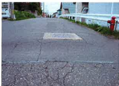
「村崎野のマンホールが」 投稿名:「シャンミ」さん 地震でアスファルトが一部下がり、 段差ができています。
