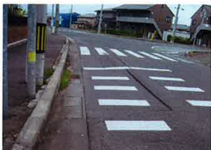
「常盤台二丁目の道路の亀裂」 投稿名:「おが」さん、「ラガーマン」さん2名 株式会社山善の東側の道路に亀裂が入っ ています。
